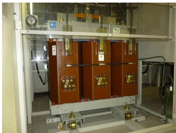
内服固形剤棟モールド変圧器導入（静岡事業所）
