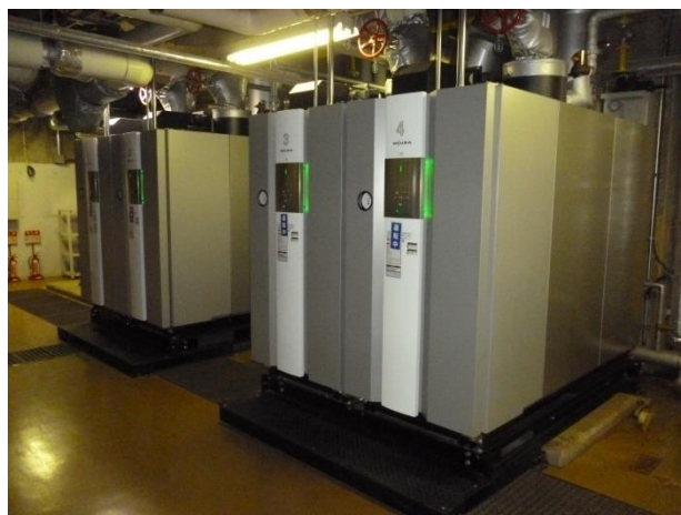
注射棟高効率ボイラー導入（静岡事業所）
