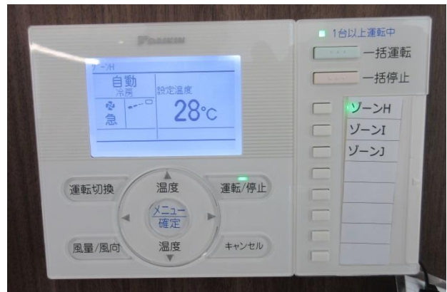
支店ビルなどに設置されているゾーン設定が可能な空調装置。
